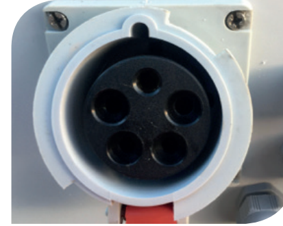
Resim 2 - 380V Elektrik bağlantı girişi.
